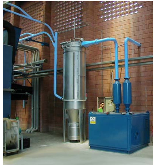
Impianto di trasporto pneumatico
